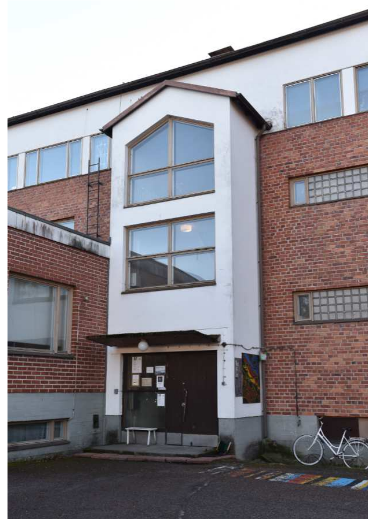
Kuva: Rakennuskompleksin ainoa arkkitehtoninen kohokohta on 1960-luvun alussa sovitettu väritykseltään valkoiseen korotusosaan. Oven betonilippa on alkuperäinen (rapautunut).
