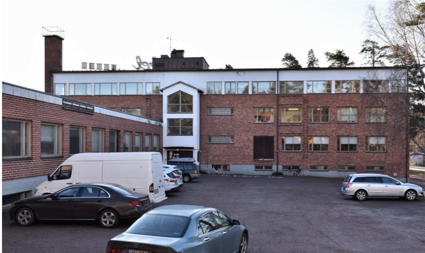
Kuva: Vanhan puolen (A) pohjoissivu, ja laajennuksen (B) länsisivua. Alun perin pääsisäänkäynnin portaali nousi räystäslinjan yläpuolella ja muodosti katonlappelle pienen poikkipäädyn. Lasitiili-ikkunat avautuvat WC-tiloihin.
